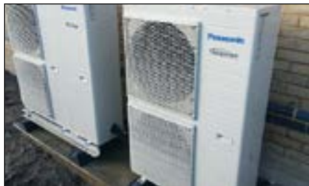
COP 2,7 Testen viser at familiene får ca. 2,7 kilowattimer varme og varmt vann for hver kilowattime el som tilføres varmepumpen.
