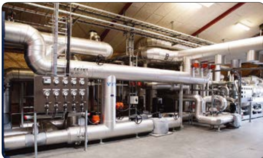
Varmepumpen i Brædstrup, der udnytter overskydende vindmøllestrøm.
