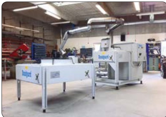
Luftkølet vandkøleanlæg fra Bundgaard Køleteknik A/S med det miljøneutrale kølemiddel R290 Propan. Anlægget er på ca. 15 kW med semihæretisk stempelkompressor, pladeveksler, luftkølet kondensator mm. Desuden også med frikøler. Anlægget er forberedt for opsætning og tilslutning ved kunden. Inkl. el tavle og vibrationsdæmpende fødder.
